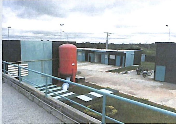
Photo 16 : Station d'épuration de la Loka © 2014
