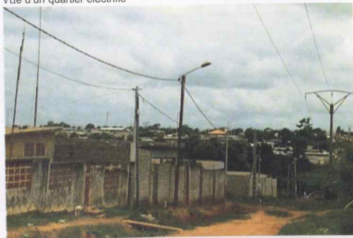
Vue d'un quartier électrifié
