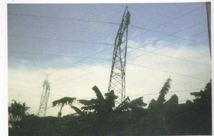
Ligne de haute tension
